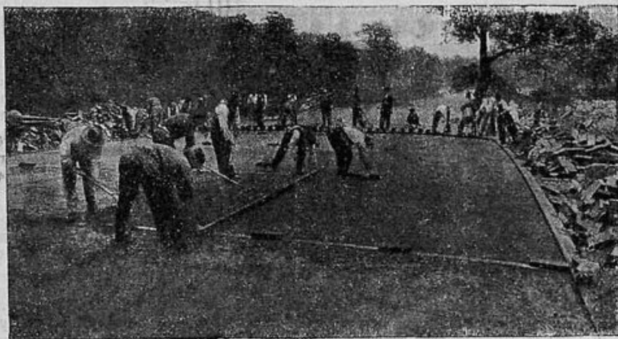
Устройство на бетонном основании цементной подушки (из раствора порландского цемента и мелкого песка) под асфальтовые плиты
